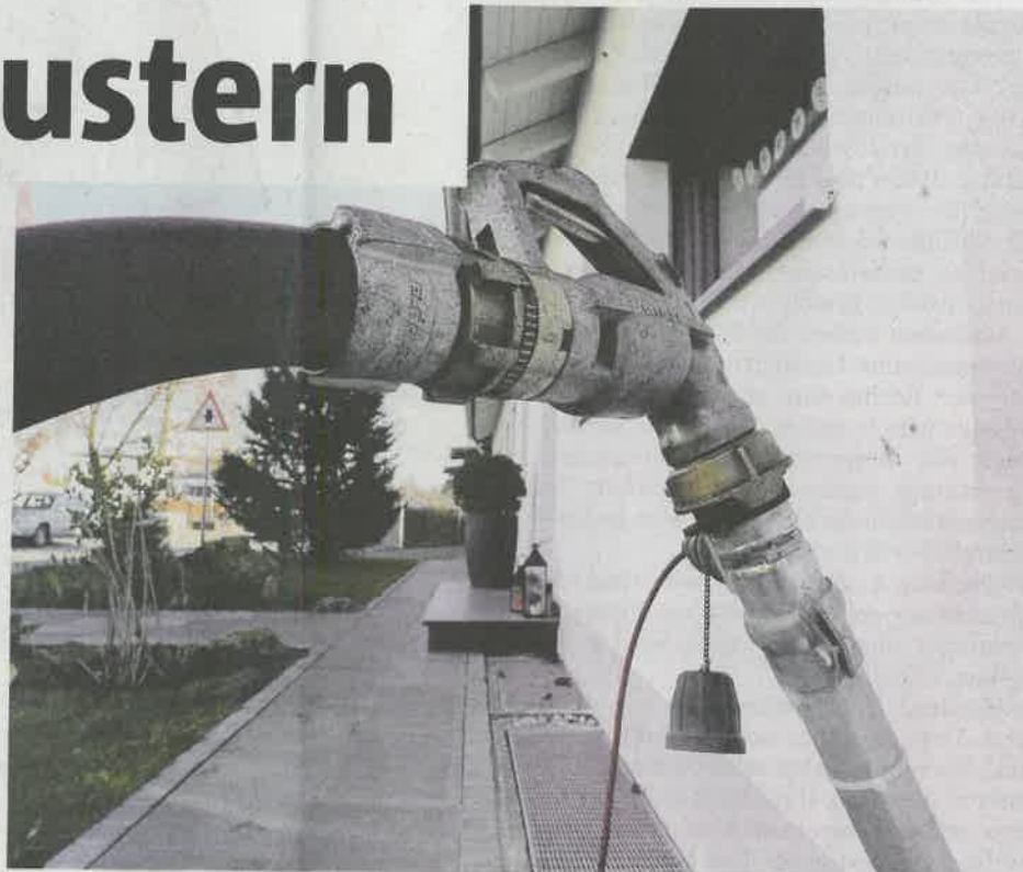
Das Bundesamt für Wirtschaft und Ausfuhrkontrolle fördert den Neueinbau von Ölheizungen ab 2020 nicht mehr.
